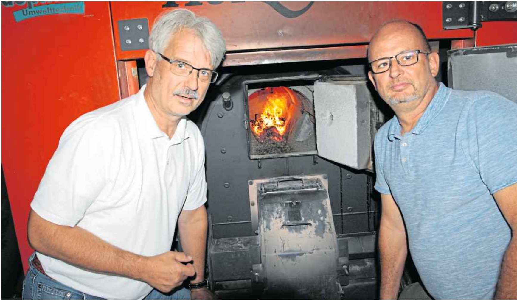
Michael Klösener (l.) und Andreas Klüe aus dem Vorstand der Energiegenossenschaft Herbram-Wald vor der vollautomatischen Holzhackschnittelfeuerungsanlage, die das Kernstück der Wärmeerzeugung für den Ort ist. Foto: Uwe Müller
